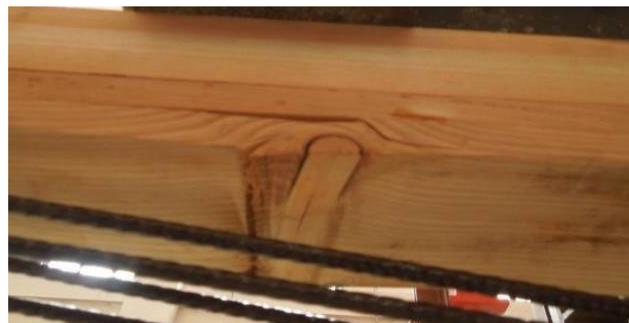
(d) Failure mode of beam L_{A2-4}
